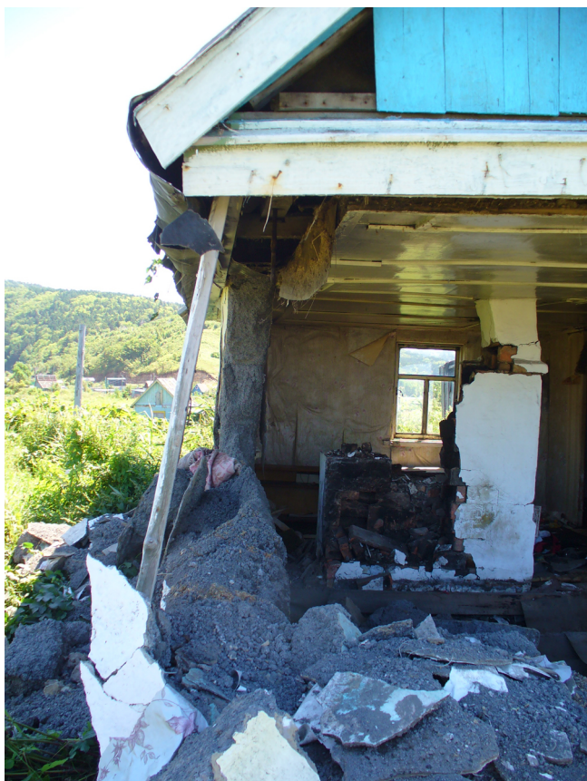
Рис. 7. Пос. Лопатино. Разрушение стены дома и печи. Фото О.М. Шестаковой.
